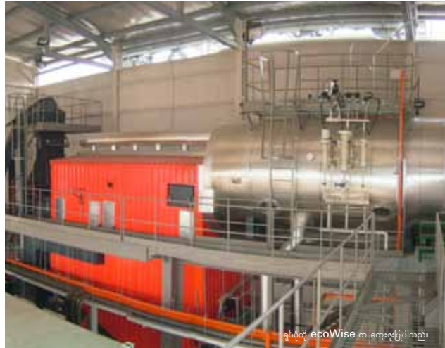
ဇီဝမြုပ်ထည် လျှပ်စစ်နှင့် အပူစွမ်းအင်ထုတ် စက်ရုံ-စင်ကာပူ စင်ကာပူနိုင်ငံ ecoWise ဇီဝမြုပ်ထည် လျှပ်စစ်နှင့်အပူစွမ်းအင်ထုတ်စက်ရုံတွင် စွမ်းအင်ပြန်လည် ရရှိရေးဆောင်ရွက်မှုများမှ ထွက်ပေါ်လာသော တာဗွန်များကို ဂျပန်နိုင်ငံ Kansai Electric ကုမ္ပဏီသို့ ရောင်းချခဲ့သည်။
